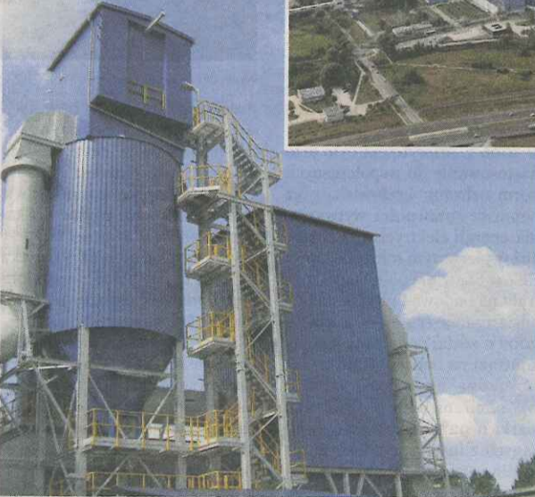
Instalacja oczyszczania spalin w PEC-Gliwice Sp. z o.o. Powyżej – widok przedsiębiorstwa z lotu ptaka.
