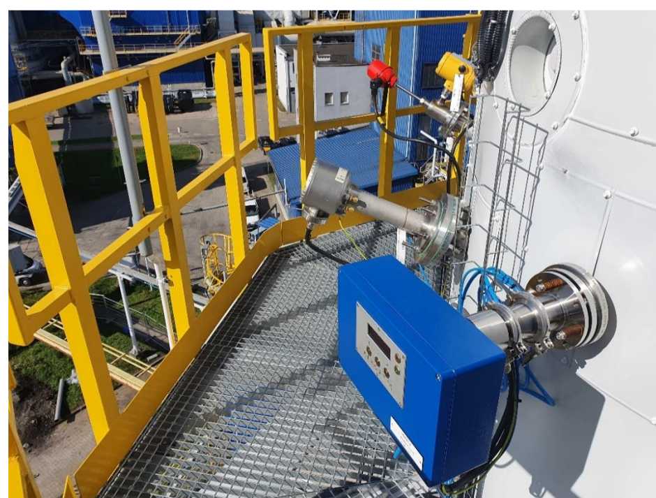
Instalacja ciągłego monitoringu spalin na jednym z kanałów spalin
