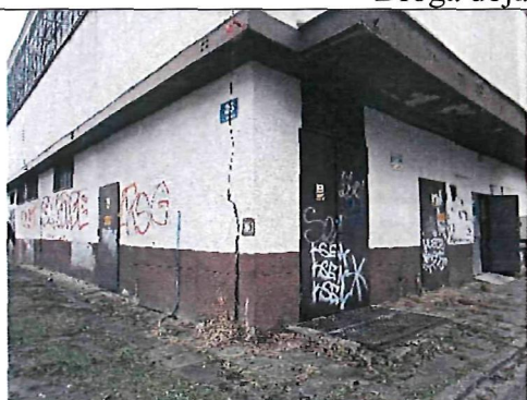
Część mieszcząca stację TRAFO
